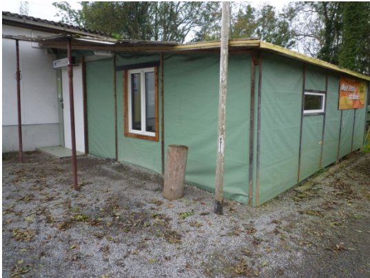
Schiessanlage Espel (defektes Vordach)
