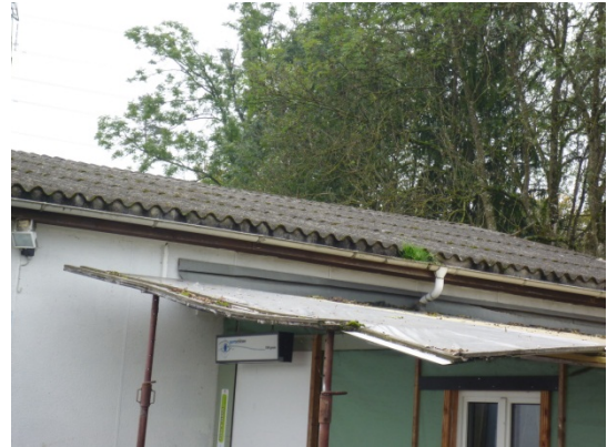
Schiessanlage Espel (defektes Vordach)
